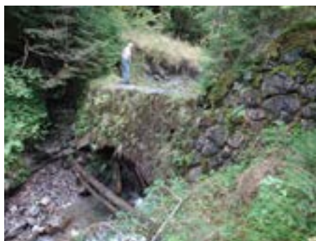
unterste Sperre der Konsolidierungsstrecke ist unterspült
