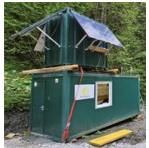
Mobile Photovoltaikanlage der Wildbach- und Lawinenverbauung
